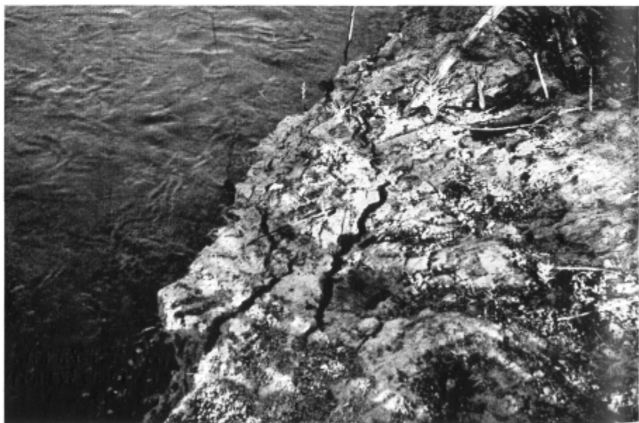
2. סדקי מתח במדרון עמקו של הירדן בין מעוז לכפר רוסיין. [למאמרו של י. שטנר]
